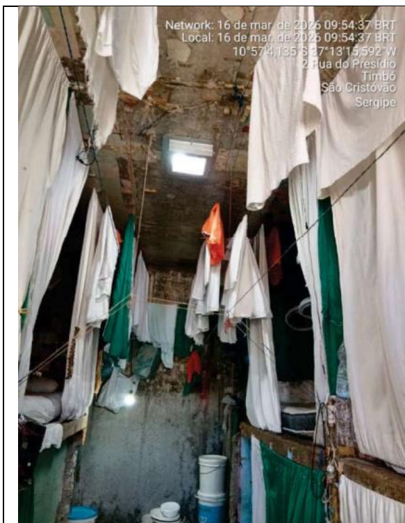
Luminária especial antivandalismo instalada no interior de cela, conforme projeto.
